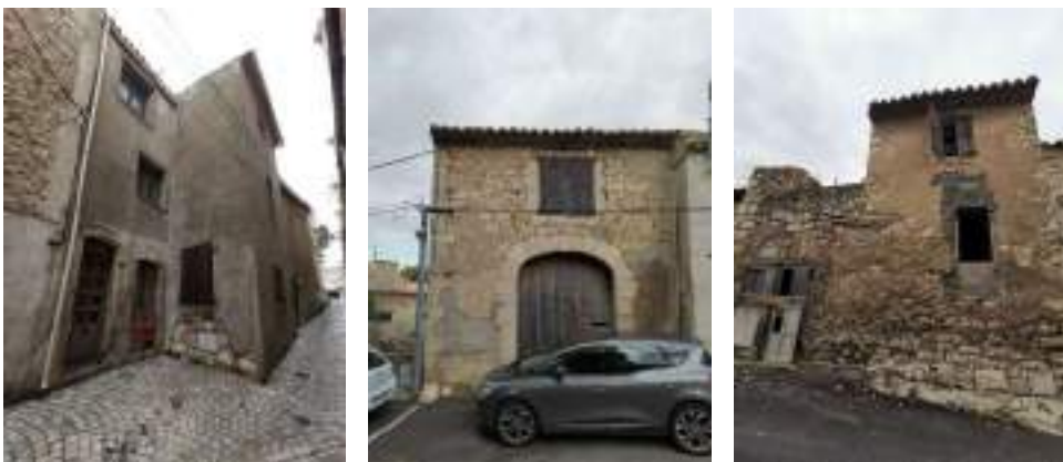
Un bâti ancien dégradé à revaloriser
